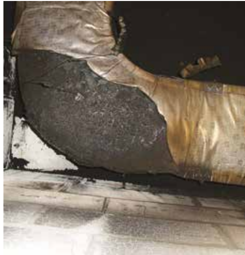
Fig. 16 - El conducto P3ductal muestra las consecuencias del incendio solamente en la parte afectada directamente por las llamas
