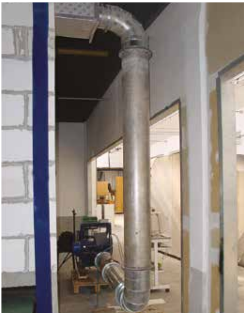
Fig. 10 - Detalle del sistema de ventilación
